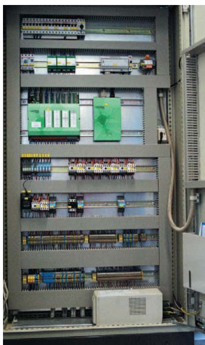
Heizungsanlage, über die Leitzentrale steuerbar
