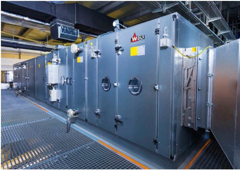
Abb. 3: Zonengeräte in Hygiene-Ausführung versorgen die OPs mit perfekt aufbereiteter Frischluft (Bild zeigt aktuellen Baufortschritt).
