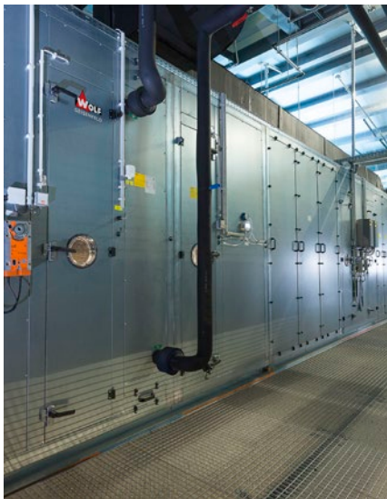
Abb. 4: Zwei redundante WK-com Zu- und Abluftgeräte übernehmen die Hauptlast der Lüftung.
