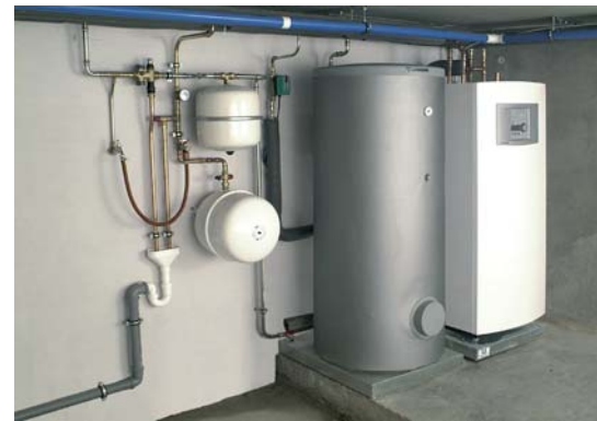
Abb.3 Heizungsanlage mit Erdwärmepumpe und Warmwasserspeicher (Junkers Kompaktgerät TE und Wärmepumpenspeicher SW)
