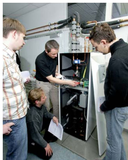
Abb.10 Bei der Produktschulung „Wärmepumpe“ arbeiten die teilnehmenden Installateure in kleinen Gruppen am Gerät
