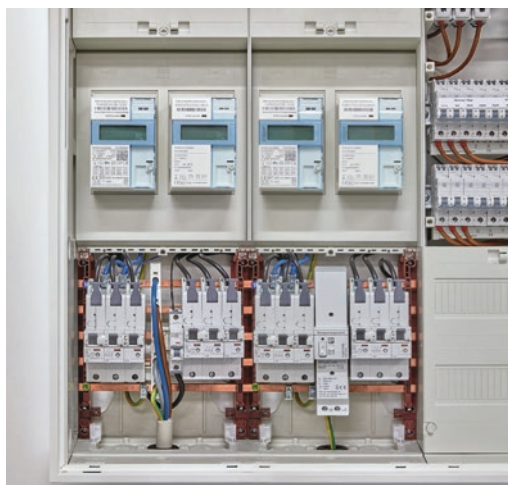
Abb.3: Flashtrab-SEC-ZP (unten rechts) ist das schmalste SPD Typ 1 für die Stromsammelschiene - es kann gemeinsam mit zwei SLS-Schaltern installiert werden
