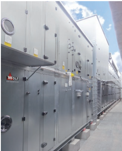
Abb.3: Alle Klimageräte wurden wetterfest ausgeführt.
