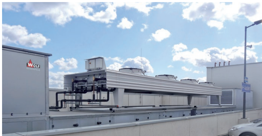
Abb.2: Externer Kondensator auf dem Gerätedach
