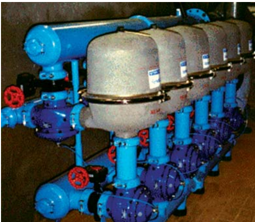
Abb.1 Chemische Industrie: Flusswasser-Filtration 220 m 3 /h, Filterfeinheit 50 µm
