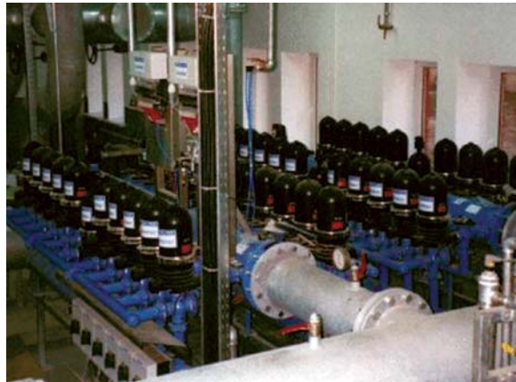
Abb.3 PVC-Industrie: Kühlwasserfiltration 600 m³/h, Filterfeinheit 100 µm
