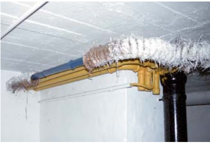
Abb.2 Auch heute noch sind viele Rohrleitungen nicht oder nur unzureichend gedämmt
