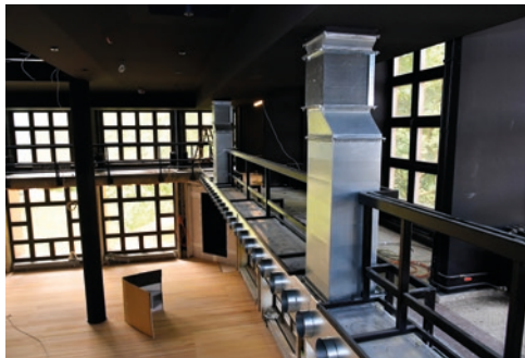
Das System aus URSA AIR Zero Lüftungskanälen sorgt für die kontrollierte Belüftung der Studiobühne.
