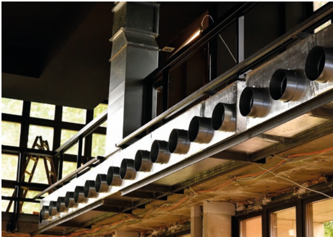
Die Luftauslässe sind horizontal angeordnet und befinden sich auf Höhe der Beleuchtergalerie.
