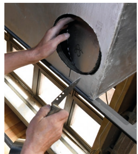
Die Aussparungen für die späteren Luftauslässe werden dank des anpassungsfähigen Materials vor Ort schnell und unkompliziert hergestellt.
