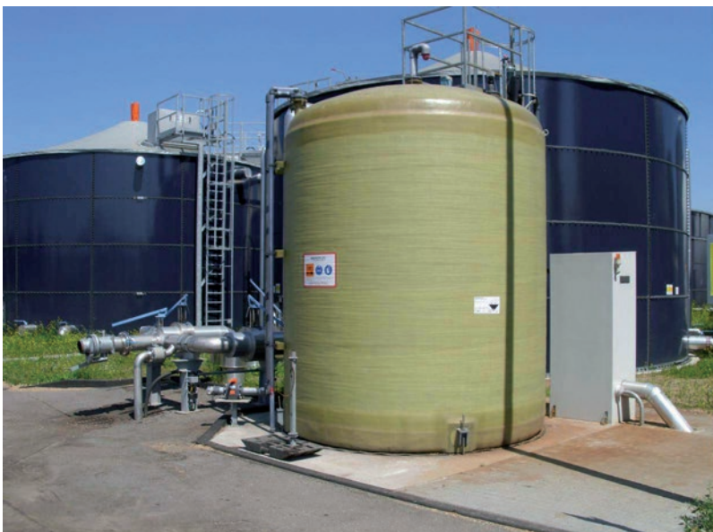
Abb.1: Tank- und Dosieranlage
