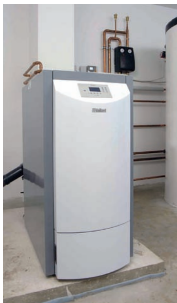
Abb.3 Pellet-Heizkessel sollten sich grundsätzlich modular erweitern lassen, so dass jederzeit eine einfache, optimale Anpassung an die aktuellen Verhältnisse stattfinden kann.
