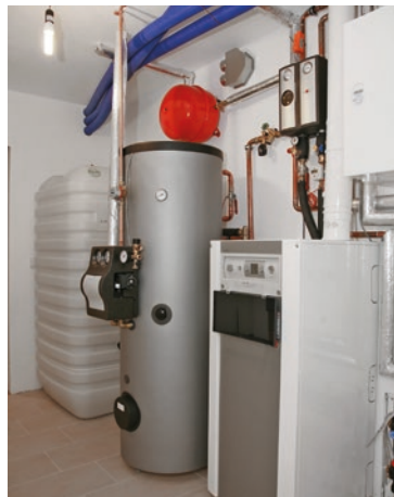
Moderner Heizungsraum mit Heizöltank, Speicher und Brennwertgerät
