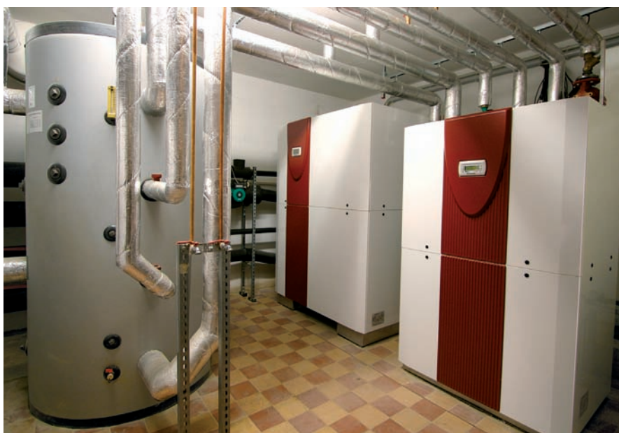
Abb.1 Der 30 m 2 große Technikraum beinhaltet 2 Wärmepumpen inkl. Heizungspuffer und separatem 1000l Pufferspeicher.
