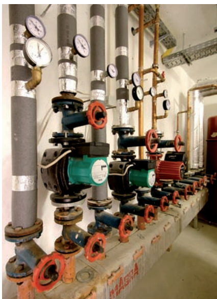
Abb.4 Von hier aus erfolgen die zentrale Trinkwasserversorgung und die Beheizung aller Wohneinheiten über den Verteiler mit angeschlossenen Heizsträngen.
