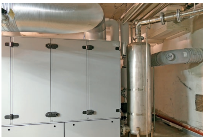
Bei dem von Wolf Power Systems (ehemals Kuntschar & Schlüter) stammenden BHKW (GTK 140) wurden alle Möglichkeiten des aktiven und passiven Schallschutzes umgesetzt. Rechts im Bild der Abgasschalldämpfer.
