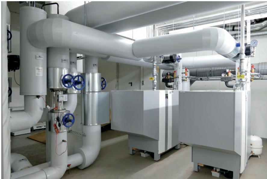
Die optimale Auslegung der Pufferspeicher sowie die hydraulische Einbindung in die bestehende Heizungsanlage tragen maßgeblich zu den langen Laufzeiten und zur hohen Effizienz des BHKW bei. Bestimmende Größe ist der Lastgang der Trinkwassererwärmung.
