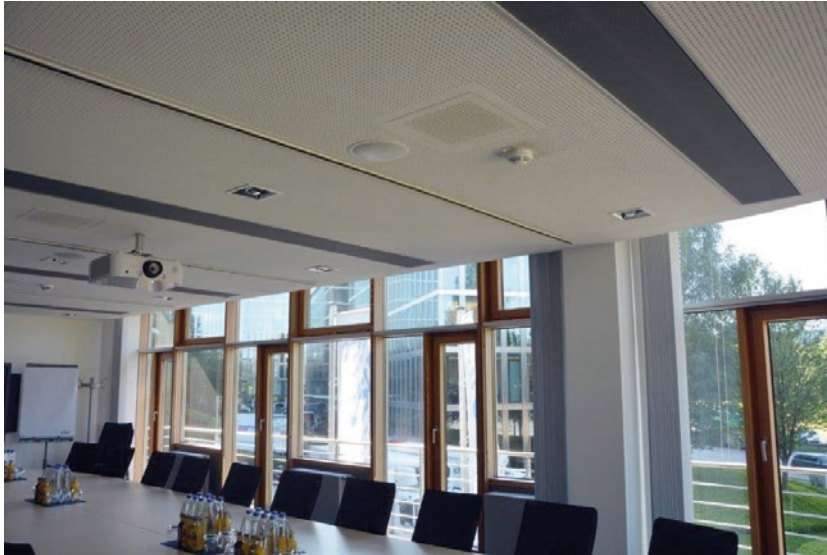
Besprechungsraum ausgestattet mit INDUCOOL-Paneeelen und INDUL Schlitzdurchlässen
