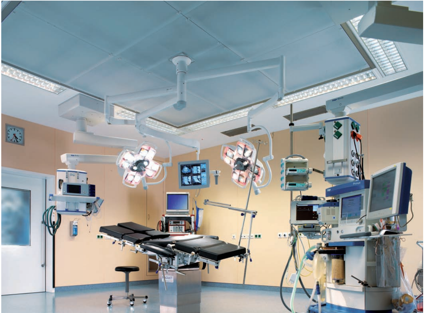
Abb.1 Zuluftdecke im Operationssaal des Klinikums Lich
