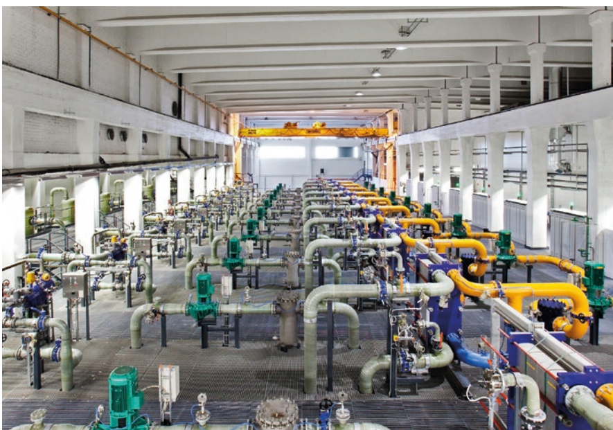
„Green IT“ par excellence: Die grünen Wilo-Pumpen der Baureihe „CronoLine-IL“ tragen mit hohen Wirkungsgraden und geringen Life Cycle Costs zur beispielhaften Effizienz des Google-Rechenzentrums in Hamina bei. (Foto: Google)
