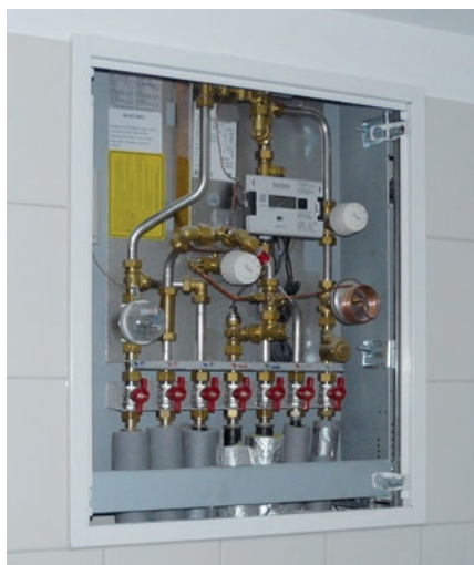
Abb.5: Wohnungsstationen können sehr platzsparend und optisch zurückhaltend installiert werden – hier beispielsweise im Bad.
