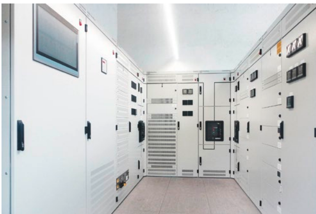
Vamocon-Anlage im Kesselhaus: Hier wird das Blockheizkraftwerk in die 20 kV Ringleitung eingebunden. Foto: Sedotec
