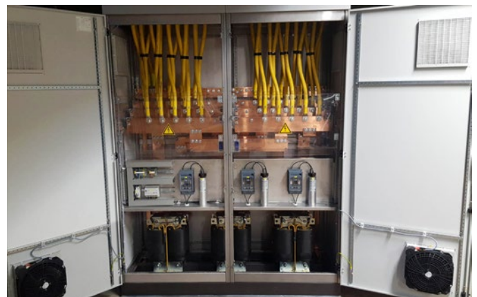
Auch die 2000 A Hochstromdrosseln der Tonfrequenzsperre wurden in den stabilen VAMOCON-Feldern untergebracht. Foto: GS Energietechnik
