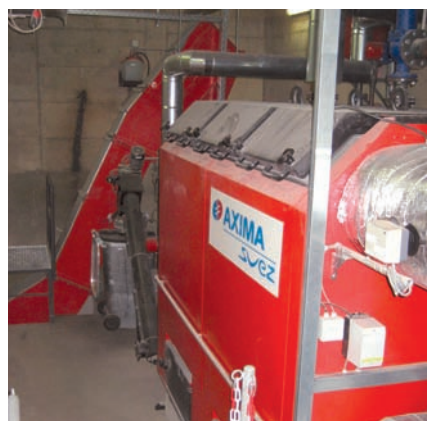
Abb.4 Neuer Hackschnitzelkessel nach Sanierung
