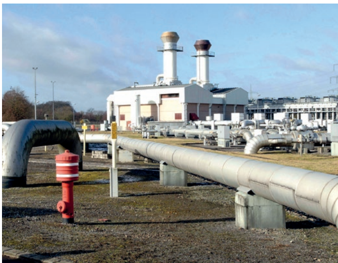
Verdichterstation Werne der Open Grid Europe (OGE)
