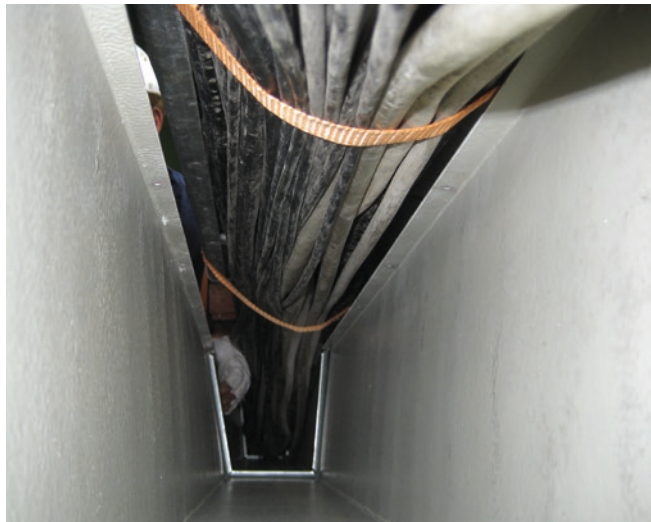
Abb. 4: Installationskanal PYROMENT IK 90 mit Beschichtung in der Praxis
