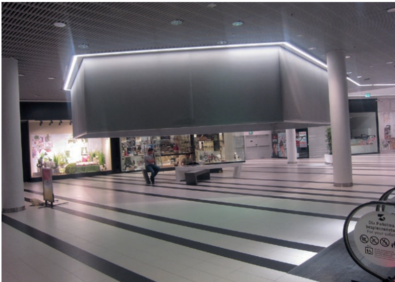
Abb. 11: SmokeMaster SM5, Rauchabschnittstrennung im Shoppingcenter Echo Kielce in Polen
