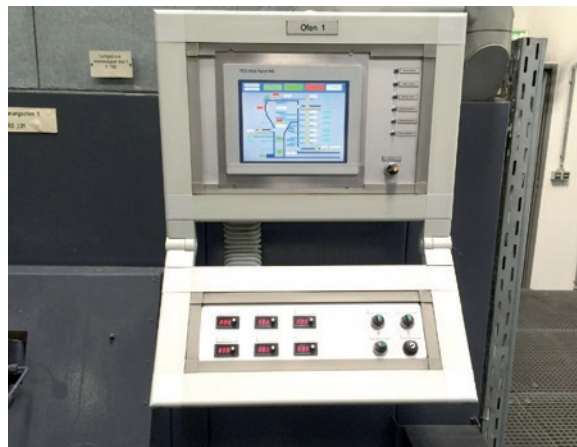
Abb.3: Das Überwachen und Bedienen der Einäscherungsöfen erfolgt über 10 Zoll Touchpanels Foto: Andreas Fricke, RTS Regeltechnik Stockfisch
